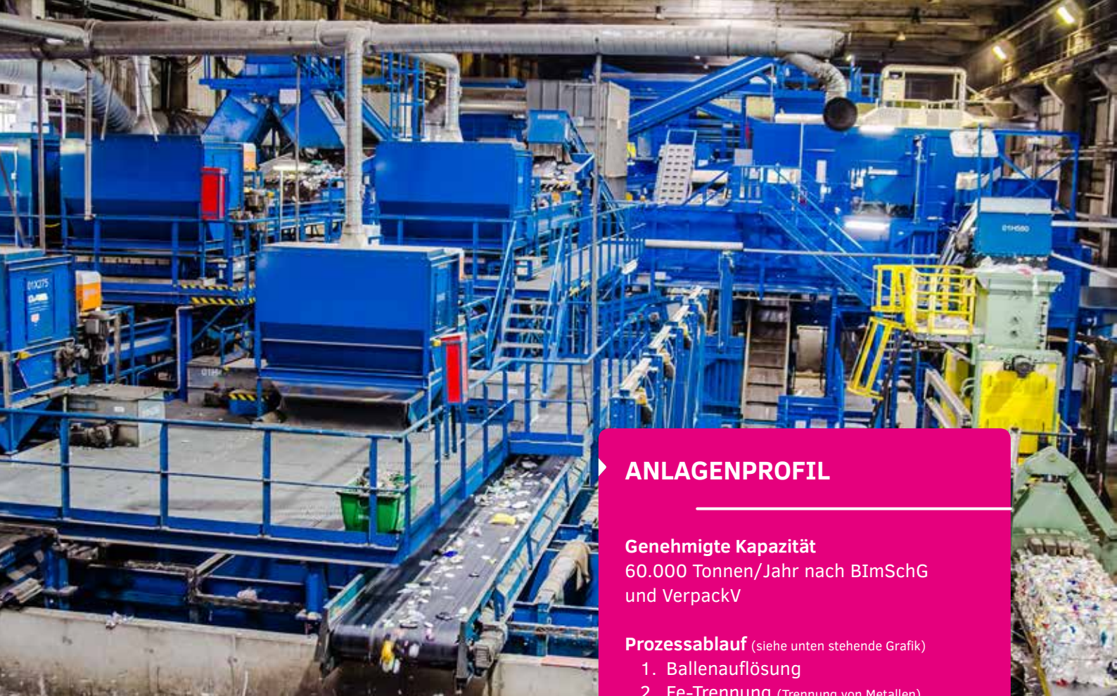
Spezielle Sortier- und Aufbereitungsanlage der Umweltdienste Kedenburg GmbH in Beckum
